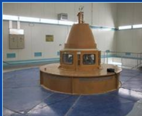
HPP DOBLAR, 1 x 50 MVA SLOVENIA
